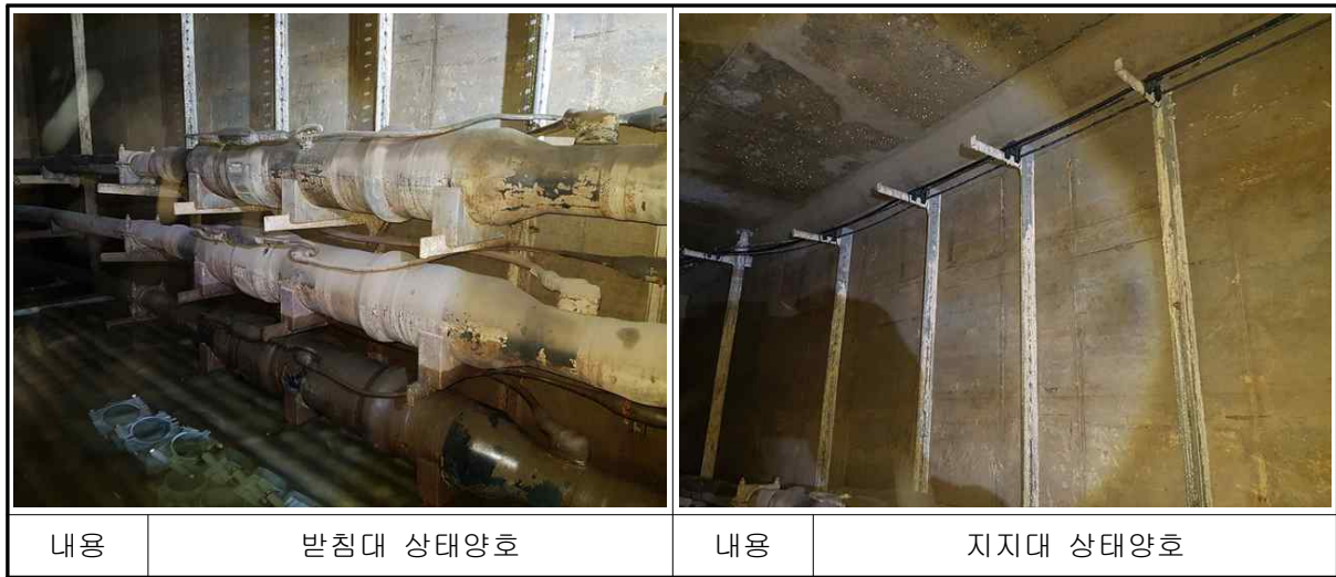
【사진 2.16】 부속 및 부대설비 현황
