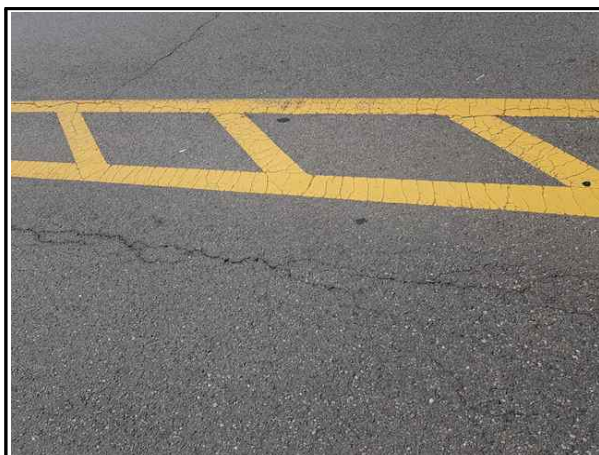
내용 도로포장 아스콘균열
