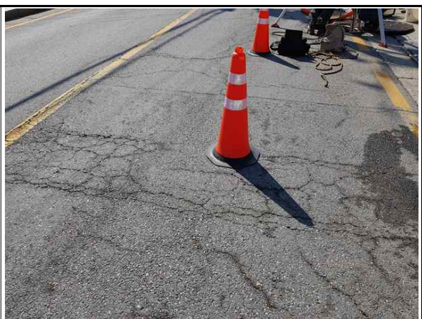
내용 도로포장 아스콘망상균열
