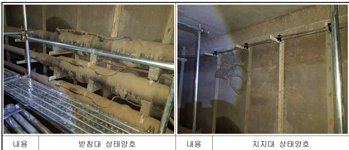
【사진 2.12】 부속 및 부대설비 현황
